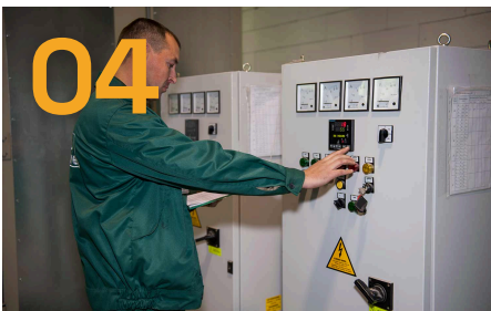
04 Contrôle du traitement thermique
